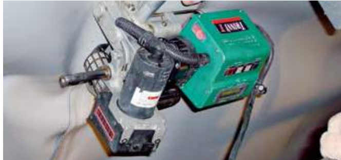
TWINNY T s praktickou příčnou rukojetí při svařování nad hlavou v tunelu.
